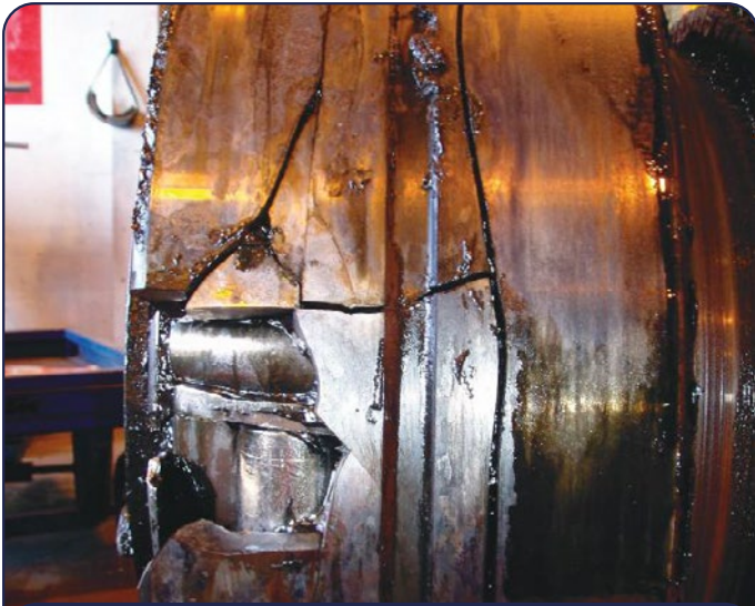
Der Schaden am Lager war sehr deutlich sichtbar und entsprach dem Muster der Tonaufzeichnung.
